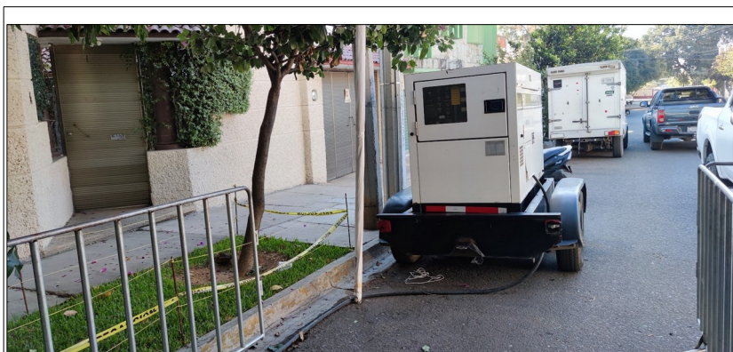
Generador de energía eléctrica
